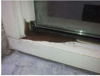
Rotte plekken in raamkozijnen
