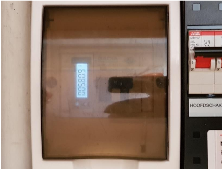
Foto van de zonnepanelen-meter
